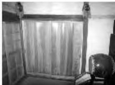
三尺坊/柱が曲がり建具に隙間
