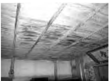
三尺坊天井/雨漏り拡大、膨らみ垂れ下がる
