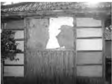
開山堂裏/壁落ち穴も開いている
