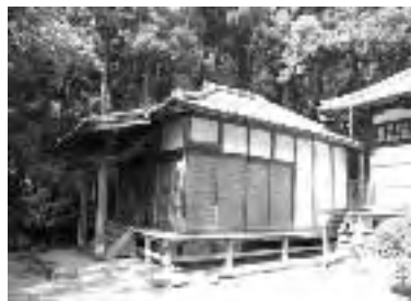
三尺坊/見た目はいいがいつ向こう側へ倒れるか判らない状態。
