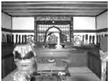
開山堂内部/天井雨漏り
