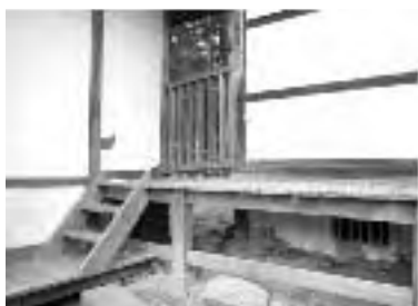
三尺坊と開山堂の繋ぎ目、屋根が重なる為雨による壁の腐れがひどい縁側は最近修理
