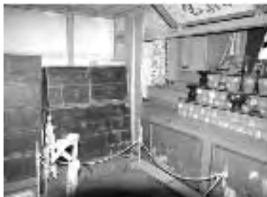
三尺坊内部/天井全体雨漏り 壁シミ
